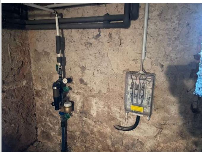
Hausanschluss Strom und Wasser
