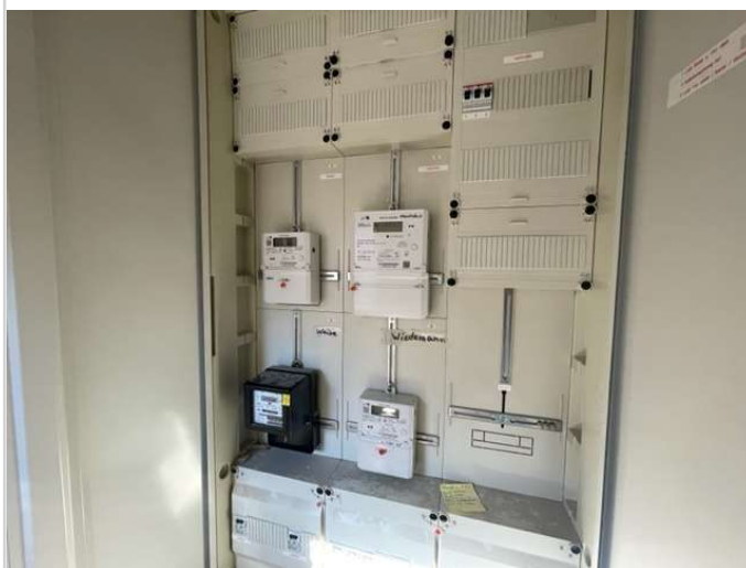
Zählerkasten im OG
